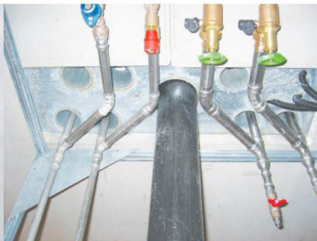
installation und ausführung brandschutz
